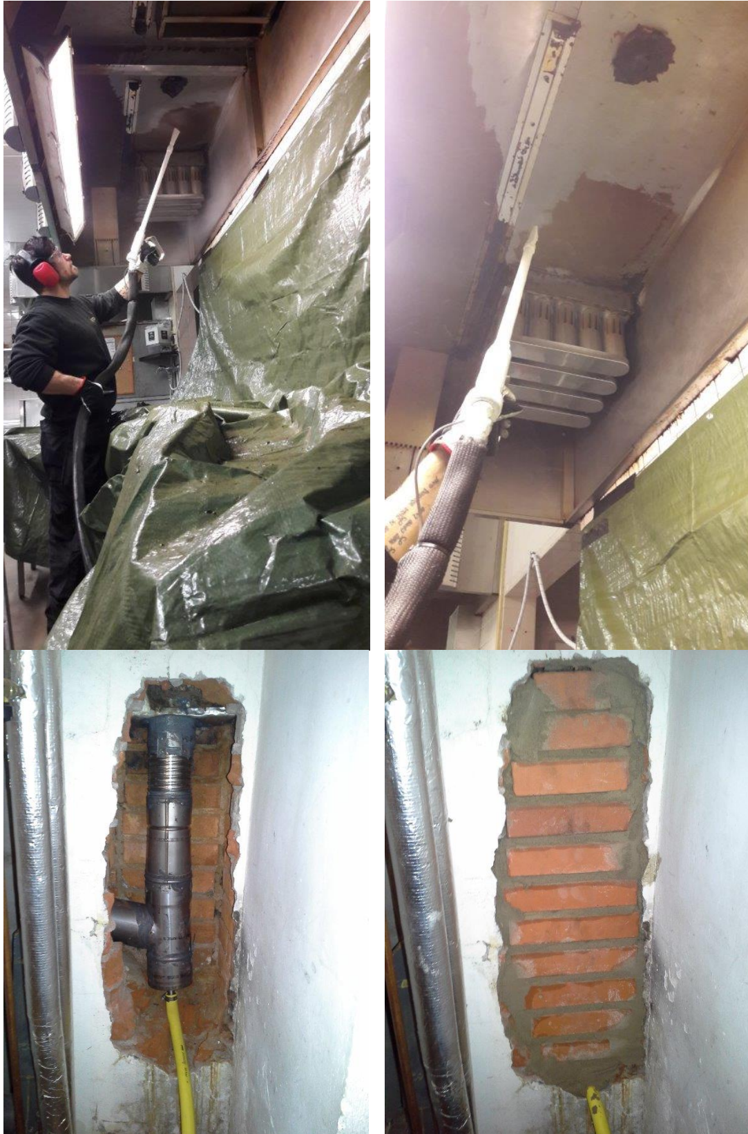
Kuva 1. Pinttyneen rasvahuuvan kuivajääpuhallus, joka soveltuu tässä tapauksessa vain kovalle rasvalle, ja on höyryn käyttöä parempi ratkaisu (vasen yläkuva). Kuivajääpuhalluksessa käytetty suutin (oikea yläkuva). Öljylämmityksen kattilahuoneessa kattilan taakse savupiipun savukaasujen poistoputkeen asennettu kondenssiveden poistoletku (vasen ja oikea alakuva). (Kuvat: ei julkinen)
