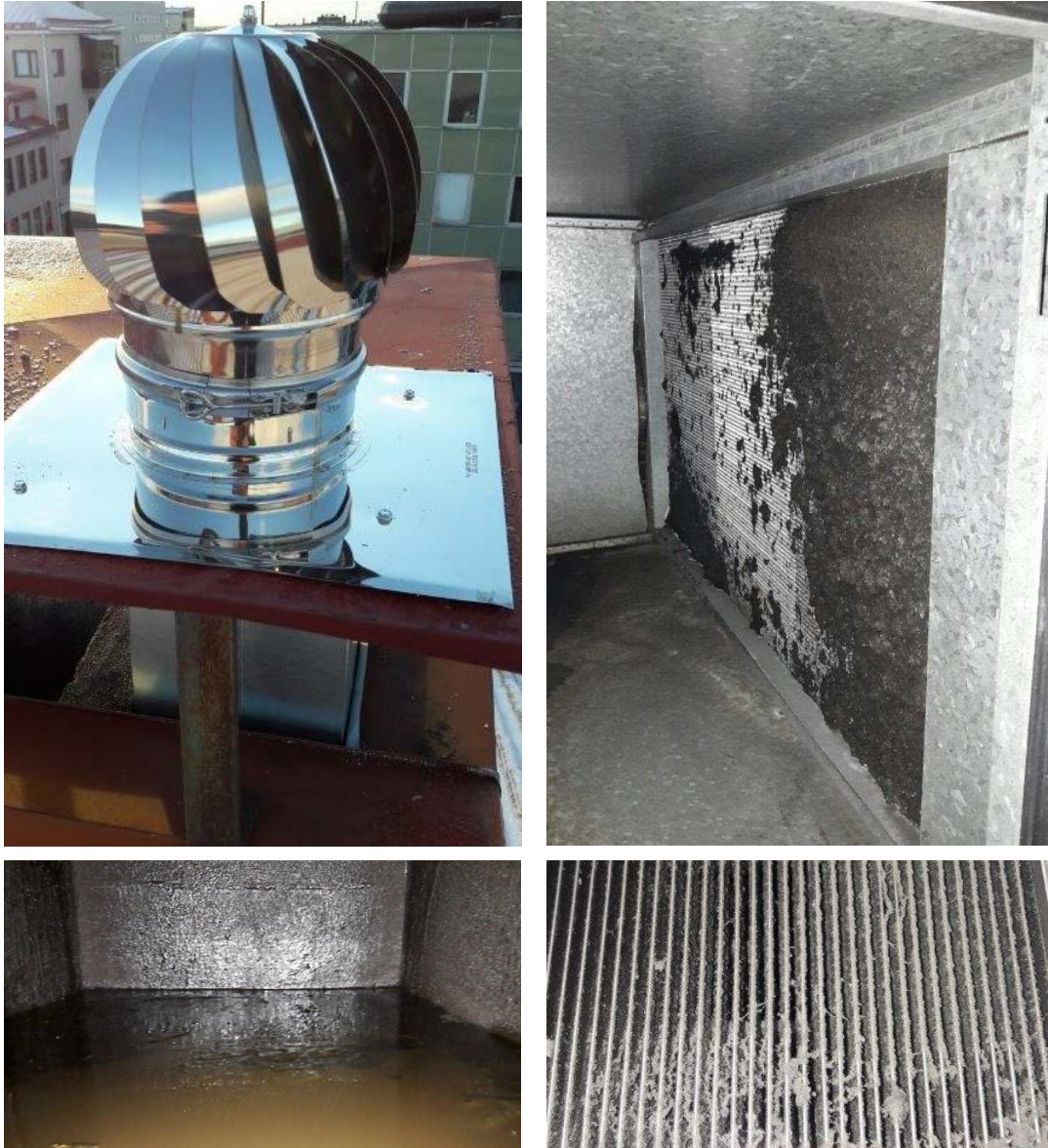
Kuva 15. Painovoimaisen ilmanvaihtojärjestelmän poistoilmahormin vedonparantaja voi parantaa sisäilman laatua kiinteistössä (vasen yläkuva). Tukkeutunut lämmityspatteri on esimerkki taloteknisten järjestelmien määräaikaisten huoltotoimenpiteiden laiminlyönnistä (oikea yläkuva). Keittiön poistoilmavaihtokanavan pohjalla oleva rasva lisää paloturvallisuusriskiä (vasen alakuva). Päiväkodin tukkeutunut lämmöntalteenottolaite estää energian täysimääräisen hyödyntämisen ja lisää paloturvallisuusriskiä (oikea alakuva). (Kuvat: ei julkinen)
